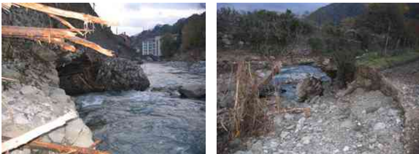
Figura 15 – varco nel muro in sinistra idraulica aperto dalla piena del 25 ottobre 2011
