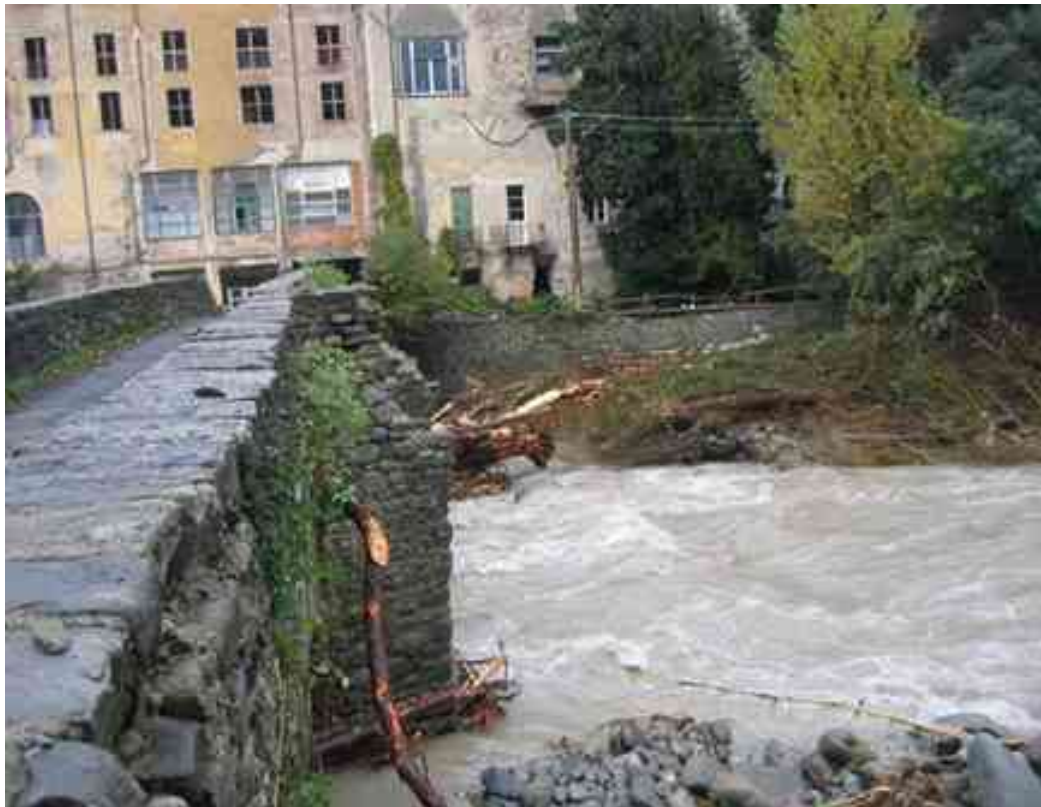
Figura 14 –Lato di monte del ponte in prossimità del vecchio ospedale sez. Ma_073 in seguito all'evento del 25 ottobre 2011
